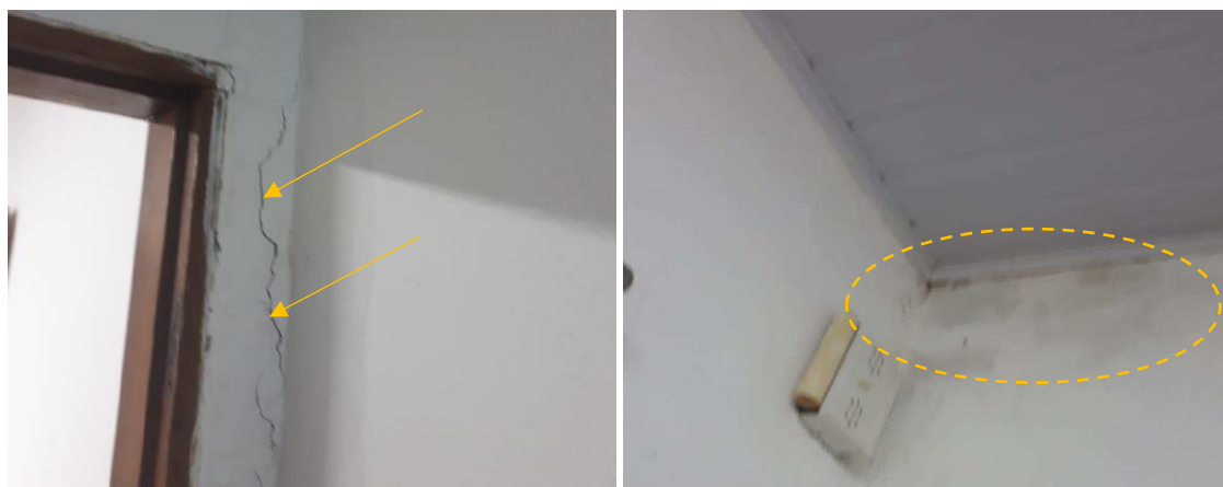
Fotos 14 e 15: Vistas das patologias do imóvel
