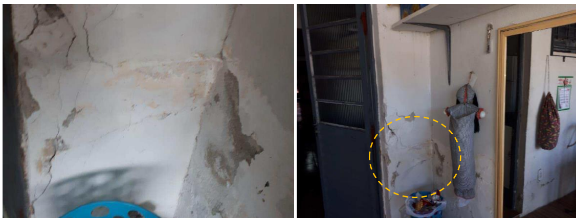
Fotos 12 e 13: Vistas das patologias do imóvel
