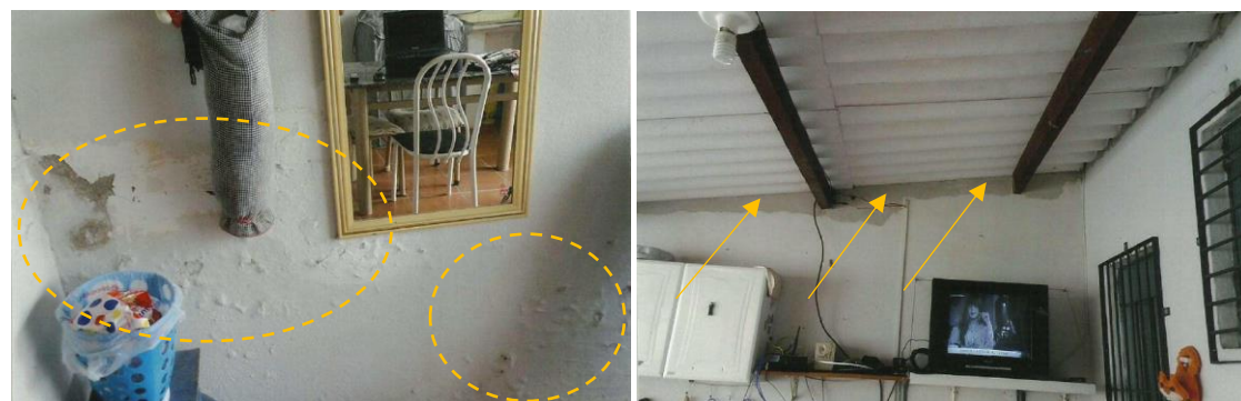
Fotos 16 e 17: Vistas das patologias do imóvel
