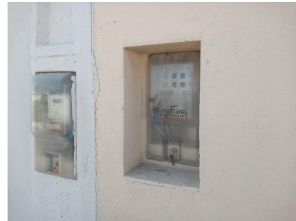
Representação Fachada Principal Descrição Medidor de energia Data Foto 29/06/2022
