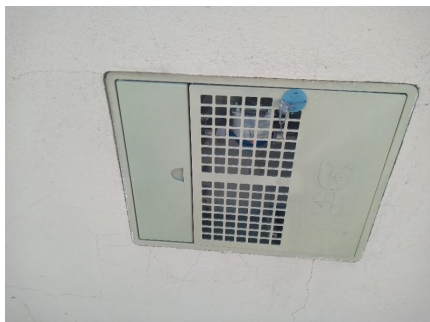
Representação Fachada Principal Descrição Cavalete de água Data Foto 29/06/2022
