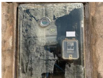
MEDIDOR DE ENERGIA
